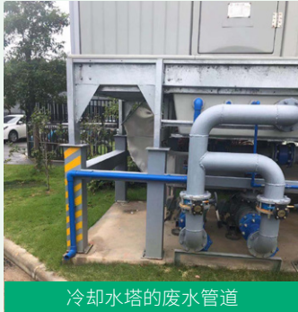
冷却水塔的废水管道
